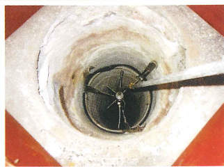
現状の石綿材 (カポスタック)
